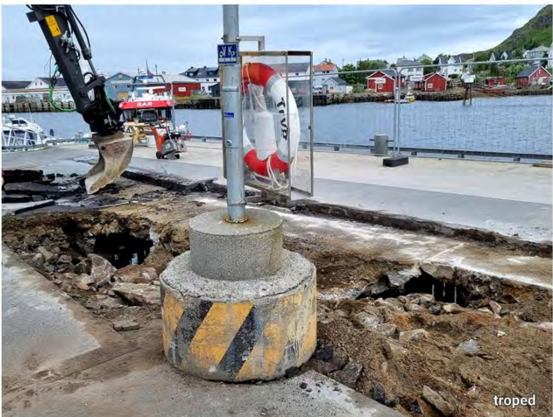
Rast ut: Slik så det ut på allmenningskaia på Ballstad tirsdag. Deler av kaiområdet har fått store skader, etter at deler har rast ut. Foto: Trond Pedersen
