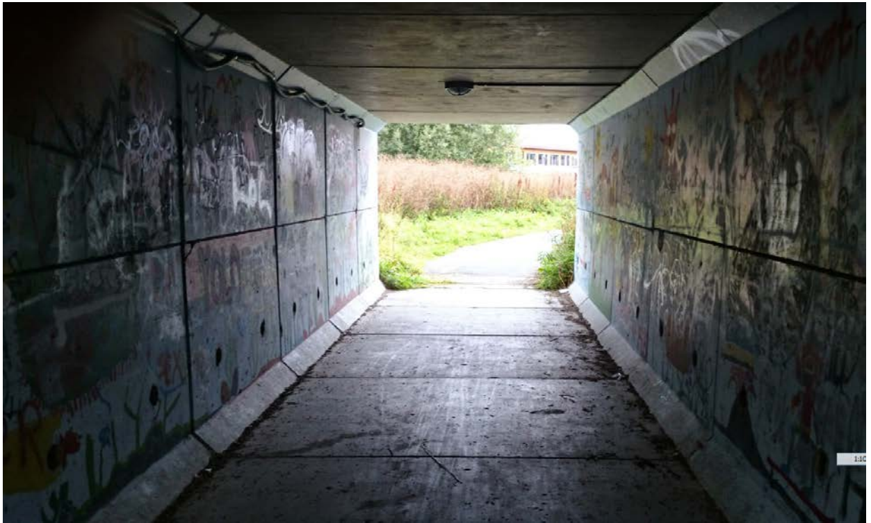
Undergangen med dårlig belysning er mørk og lite trivelig.
